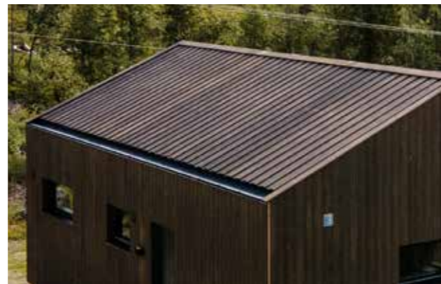
TAK Tretak, sveiset membran fra Protan, taktro, isolasjon i.h.h.t TEK10, plast og himling (panel). Skjult takrenne.
